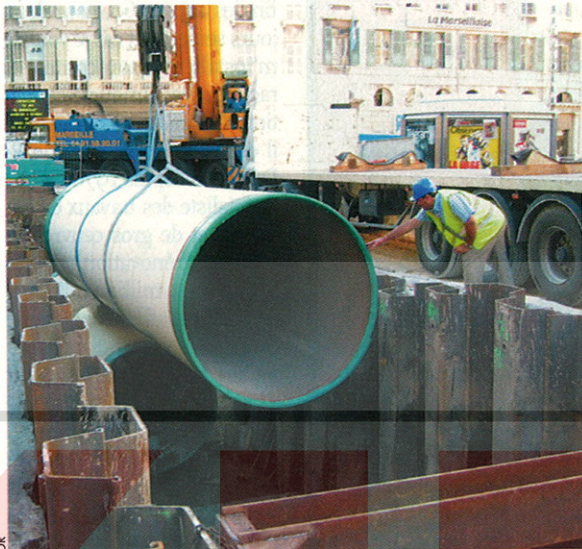
Ce tuyau «anti-inondation» de 2 m de diamètre permettra d'évacuer l'eau de pluie dans le Vieux-Port.
